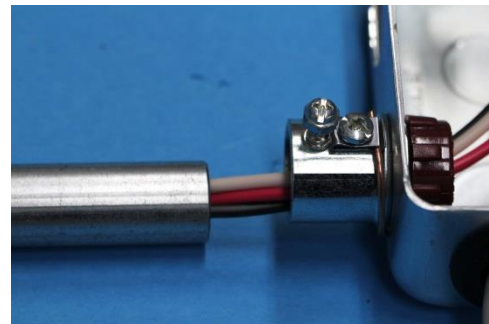
欠陥：ボックスコネクタと管との未接続 又は引っ張って外れるもの
